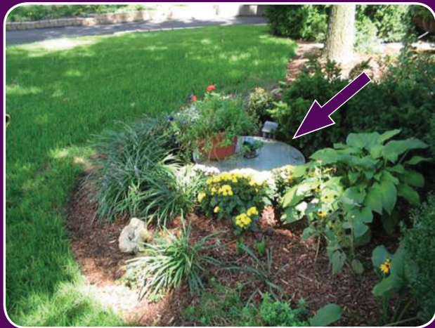
Una bomba para aguas residuales está instalada en este jardín y protege la propiedad de desbordes de alcantarillado.
